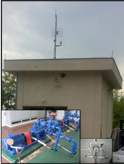
Slika 3. Pumpna stanica „Knez Selo“ Figure 3. Pump station „Knez Selo“
