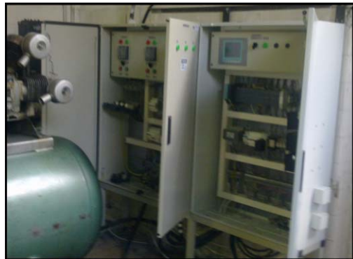
Slika 6. Pumpna stanica niskog pritiska „Mediana“ Figure 6. Low pressure pump station „Mediana“
