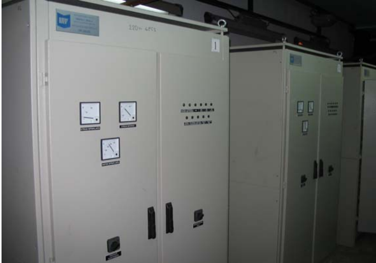
Слика 2. Фазно регулисани исправљачи ДРИ 220-250 и ДРИ 110-500 у индустријском разводу једносмерне струје Figure 2. Phase-controlled rectifiers DRI 220-250 and DRI 110-500 in industrial direct current distribution system
